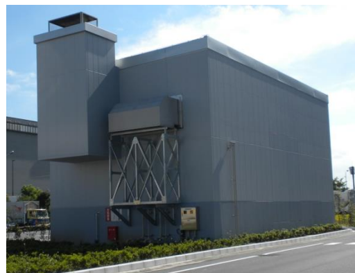
非常用自家発電設備（京浜トラックターミナル）
