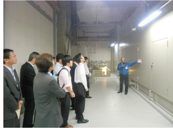
非常用発電設備の見学
