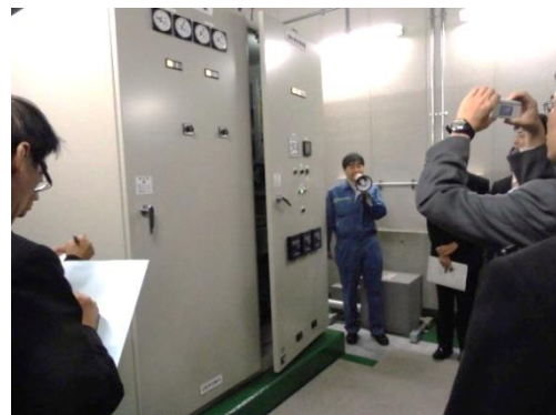
非常用発電設備の見学
