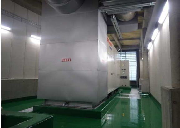
建屋内に設置されている非常用自家発電設備本体
